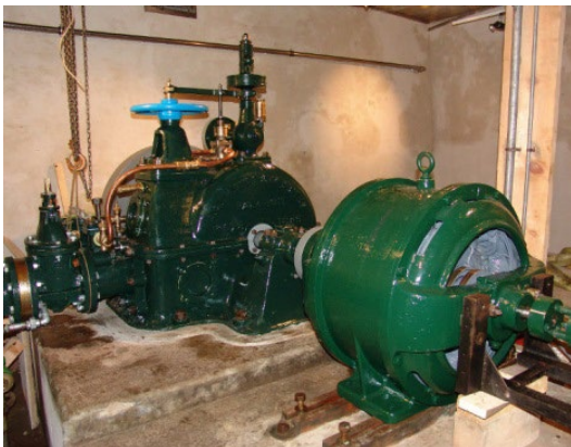
Abb. 10: Historische Turbinenanlage, Baujahr 1899 [17]
