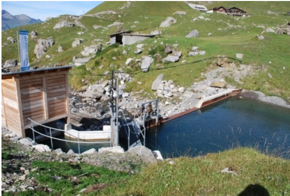
Abb. 14: Rehabilitierte Kleinwasserkraft-Anlage auf der Engstligenalp; Entnahmestelle auf 1927 m ü. NN; [31] installierte Leistung 600 kW (zuvor 60 kW)
